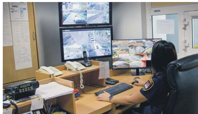
Obraz z kamer jest przesyłany na stanowisko monitoringu w Straży Miejskiej
