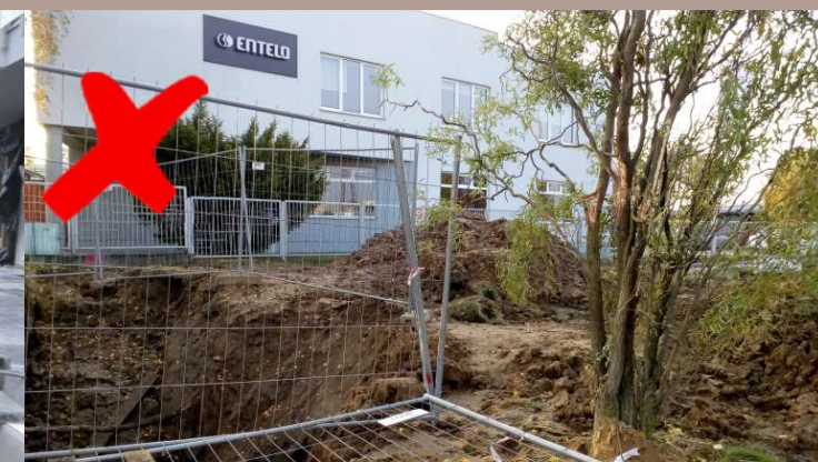
Obcięcie korzeni pogarsza statykę i żywotność drzewa
