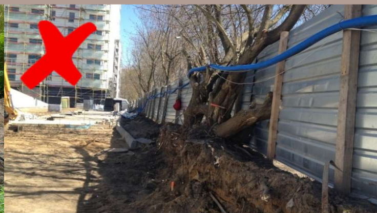
ZDJĘCIEM WIERZCHNIEJ WARSTWY GLEBY, USZKODZENIE KRYTYCZNE – RYZYKO WYKROTU
